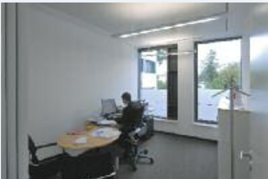
Flackerfreies Licht dank LED-Technik: In den Büros der Sparkasse kommen Pendelleuchten zum Einsatz
