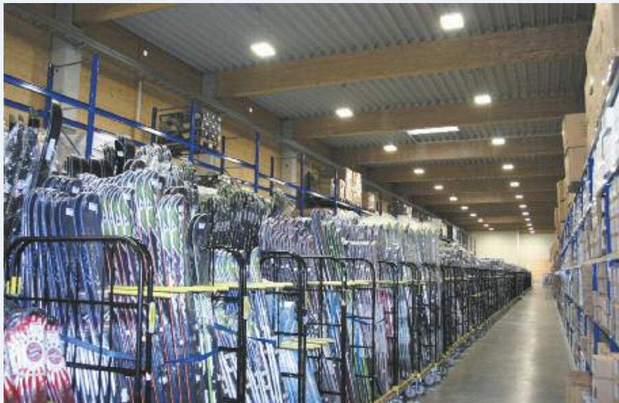
Langfeldleuchten und Hallenstrahler sorgen für die nötige Helligkeit im Lager
