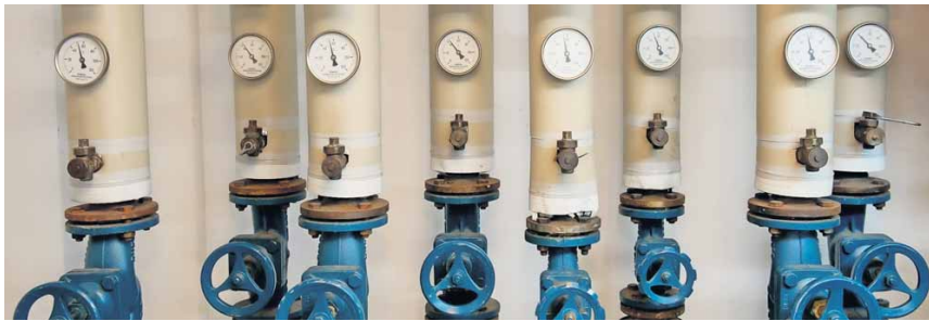
Mit der richtigen Beleuchtung und Heizung kann man viel Geld sparen. Energiesparlampen sind schon nicht mehr die neueste Technik, LED gelten als noch effizienter. Völlig veraltet ist diese Ölheizung im Keller eines Bürogebäudes.
