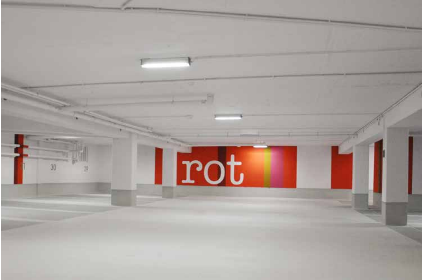
Großflächige Fahrwegsbeleuchtung in einer mehrgeschossigen öffentlichen Tiefgarage in Stuttgart
