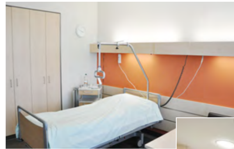
← Patientenstation Alb-Fils-Kliniken Der Wohlfühlfaktor Licht ist für Patienten ein wichtiger Baustein der Genesung. Eine normgerechte Beleuchtung ist erfüllt, wenn am Fußende des Bettes 300 lux für Untersuchungen gegeben sind.
