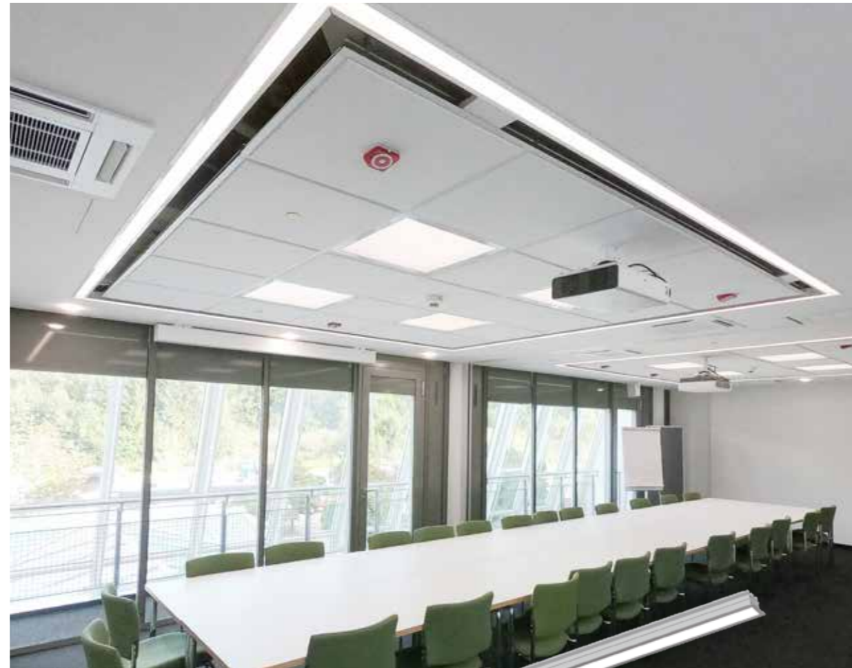
Lichtkanal EKL und ECL-one im Meetingraum eines Klinikums
