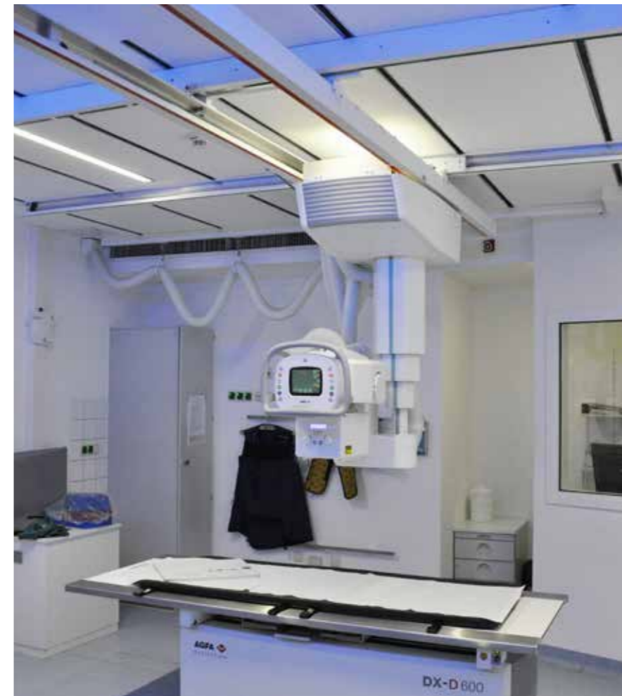
Trotz geringem Platzbedarf in der Decke schafft Einbauleuchte EKL ideales Licht im Röntgenraum
